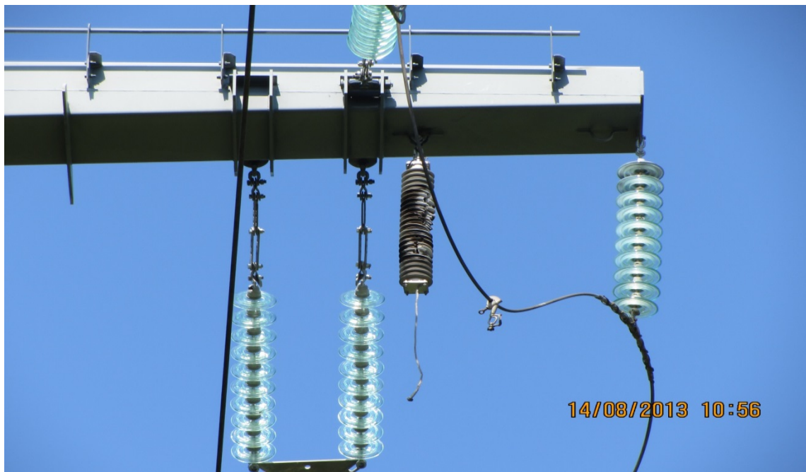
Поврежденный ОПН производства SIEMENS
